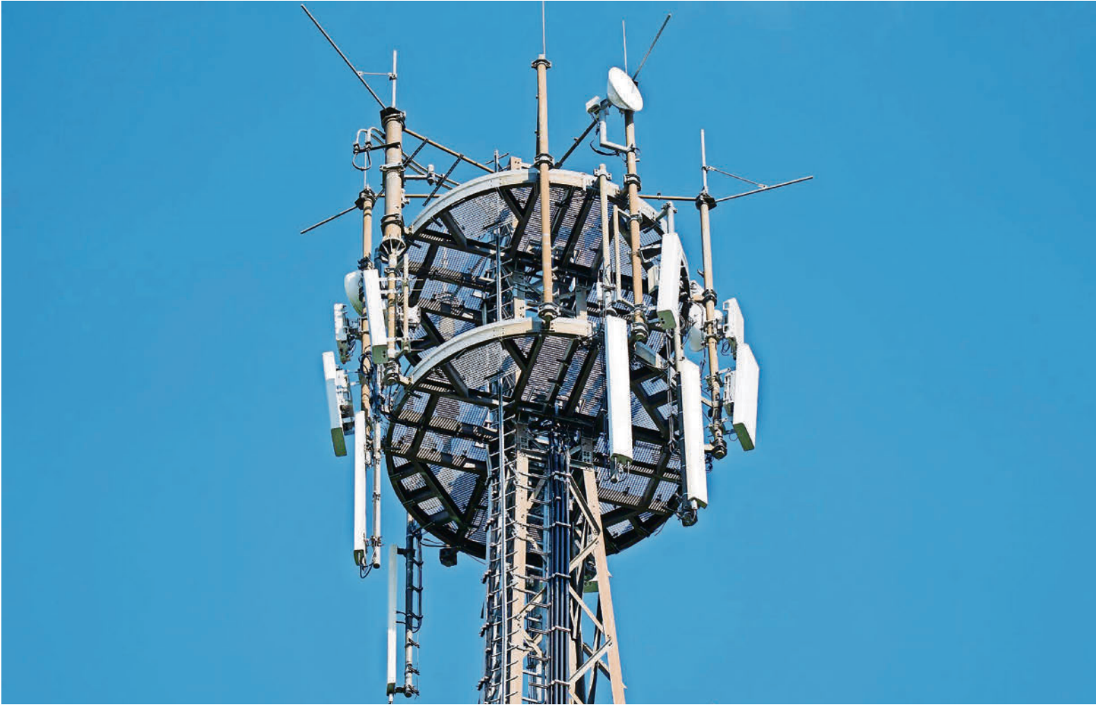
Zwischen Geschwand und Wolfsberg gibt es ein absolutes Funkloch. Ein neuer Mast - so ähnlich wie dieser - soll ermöglichen, auch hier mobil zu telefonieren. Foto: dpa
